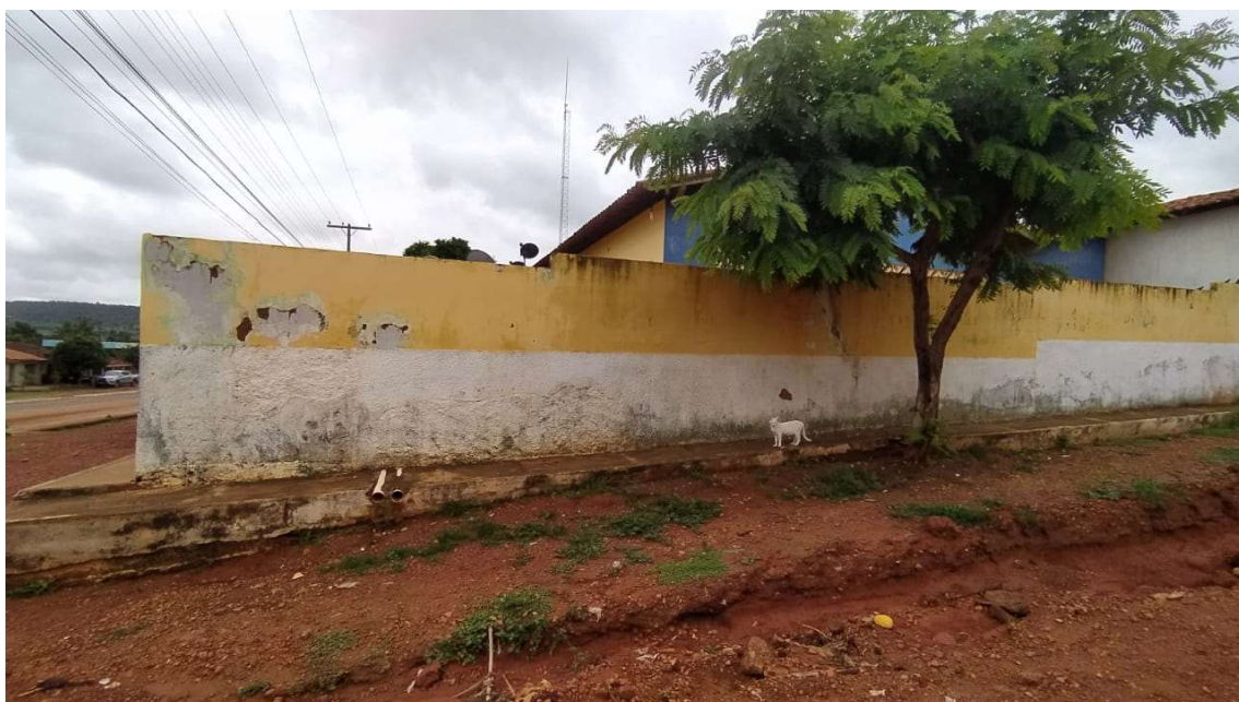
Revestimento de fachada lateral com descamação de revestimento;
