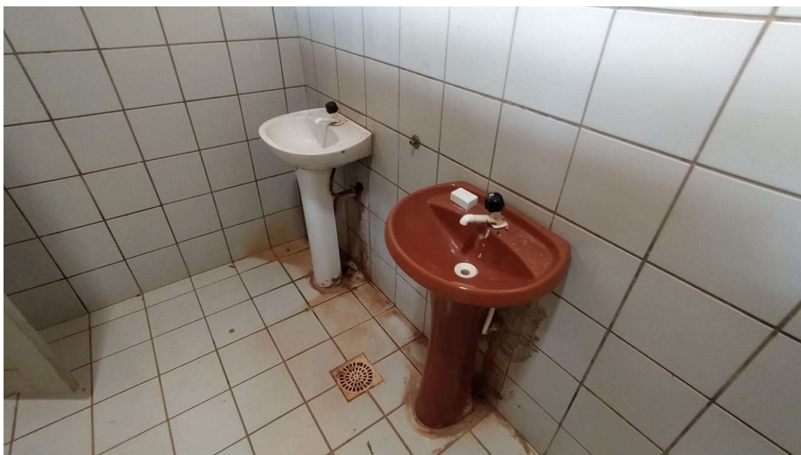
Lavatórios com mal funcionamento;
