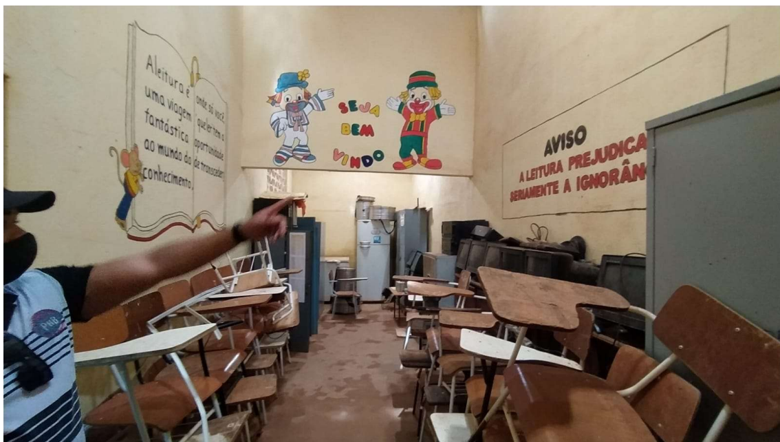
Depósitos com infiltrações, descamação do piso;
