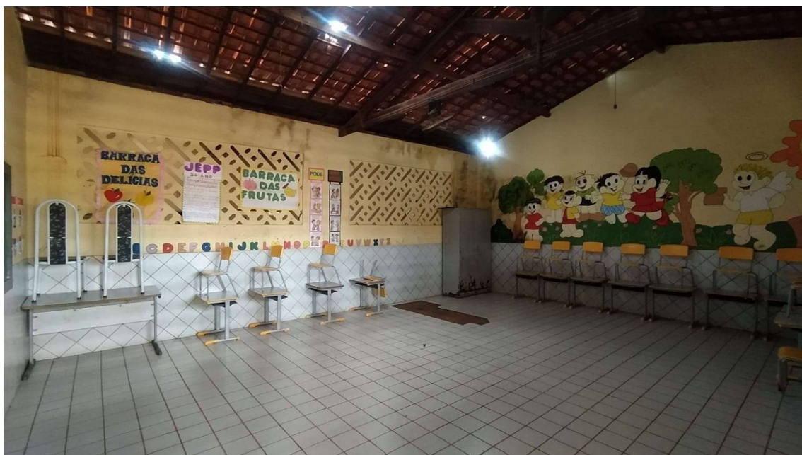
Salas com paredes com descamação de revestimento e infiltrações;
