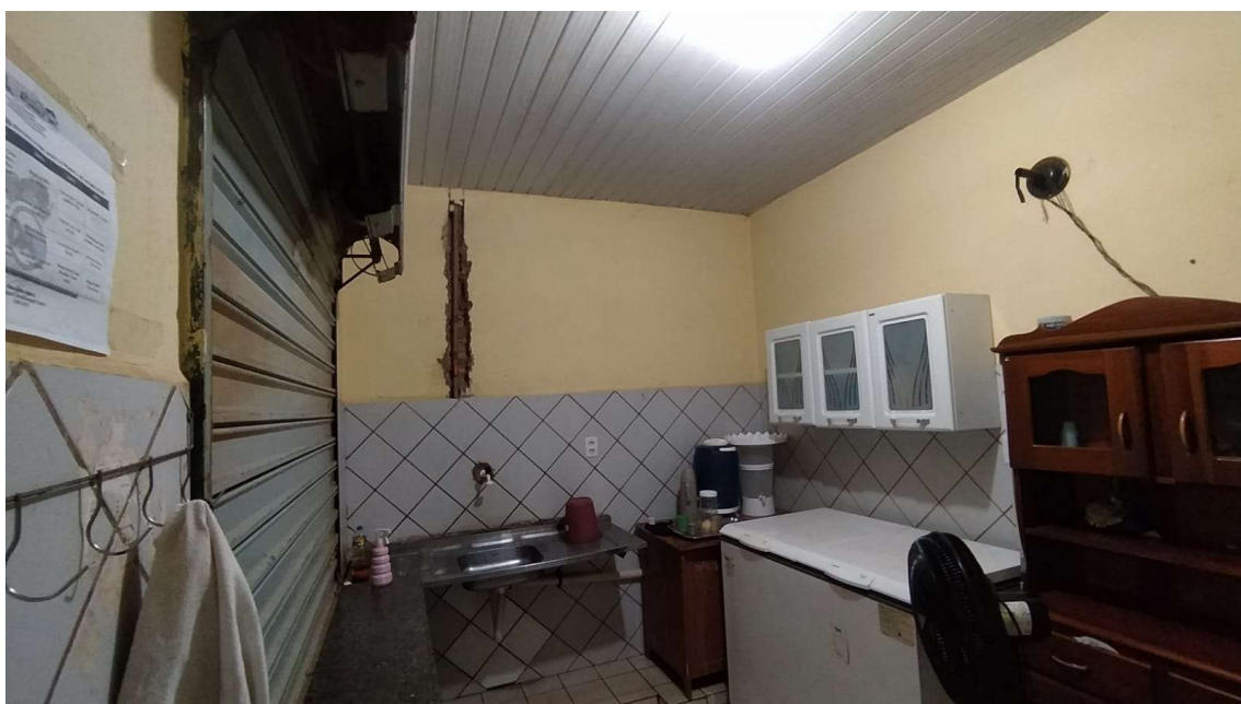
Cantina com tubulação exposta, espaço pequeno para acomodação dos mobiliários e instalação elétrica exposta;
