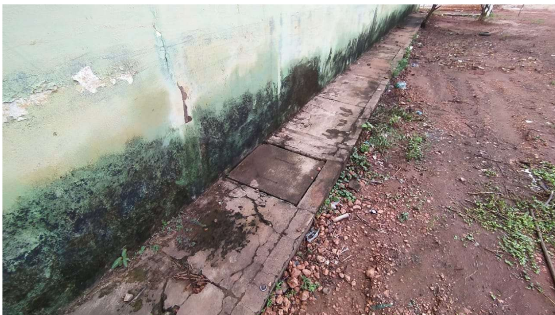
Calçadas com rachaduras e infiltrações;
