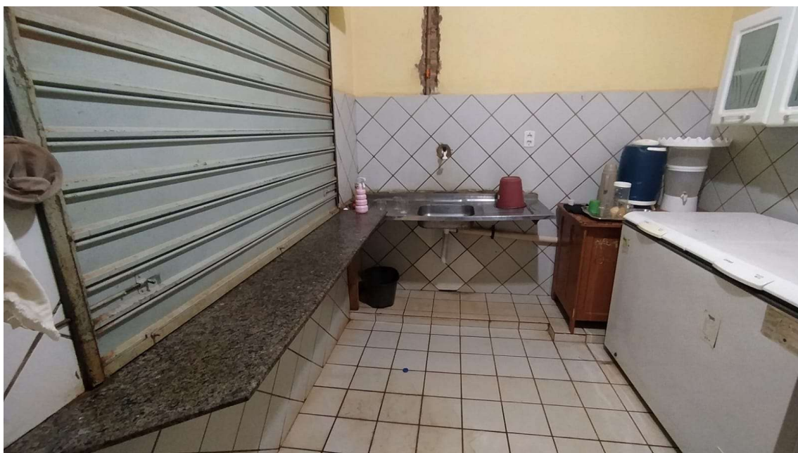
Piso desnivelado e com tubulação exposta;
