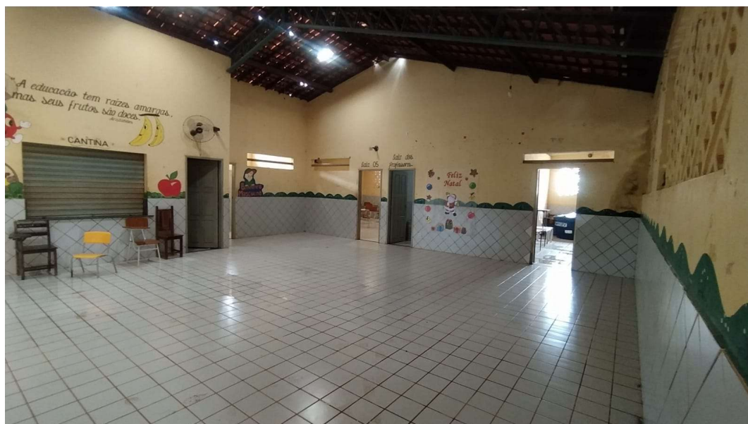
Paredes com descamação de revestimento e infiltrações
