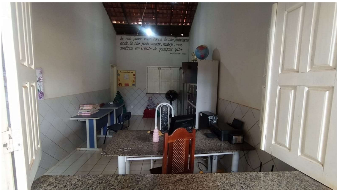
Instalação elétrica exposta e goteiras no telhado;
