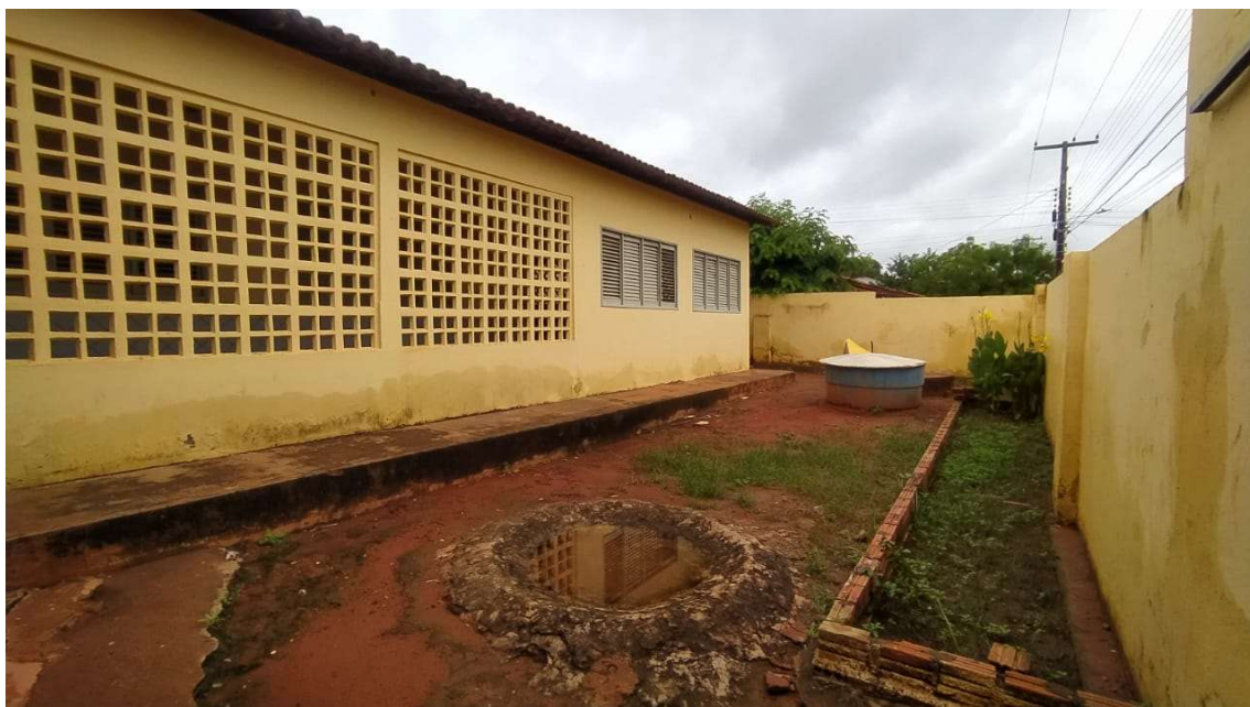
Paredes com descamação de revestimento e infiltrações;
