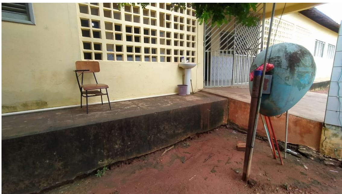
Paredes com descamação de revestimento e infiltrações;
