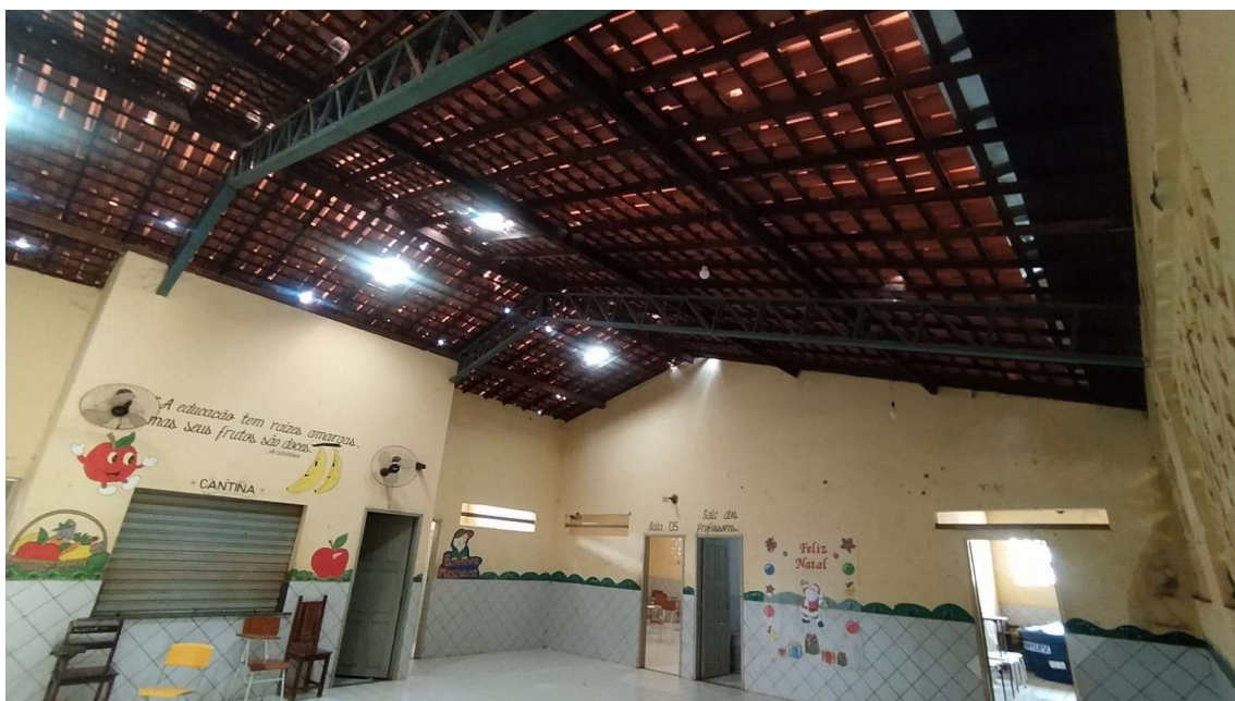
Telhado com goteiras;
