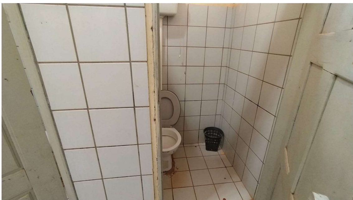
Sanitários com antigas instalações e mal funcionamento;
