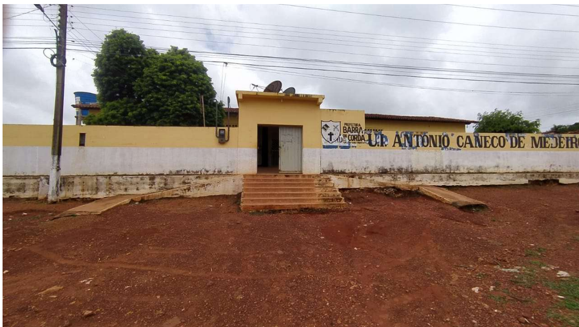
Revestimento de fachada frontal com descamação de revestimento;
